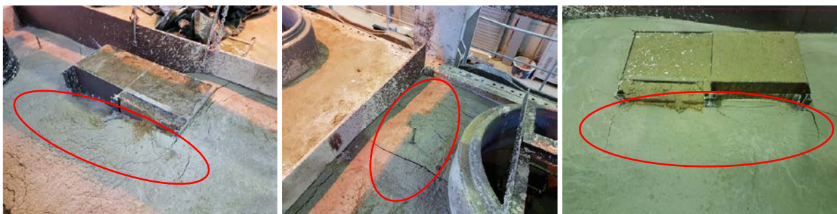
Bild 18 Risse an Verbau (links) und Schacht (mitte) bei „TerraFlow®“ und Risse bei „carbofill“ an Verbau (rechts)
